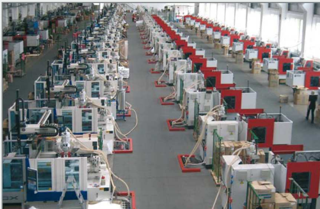
Zentralförderanlage eines großen Spielwarenherstellers mit Förderabscheidern und Trocknungsanlage zur Versorgung von 108 Verarbeitungsmaschinen.
